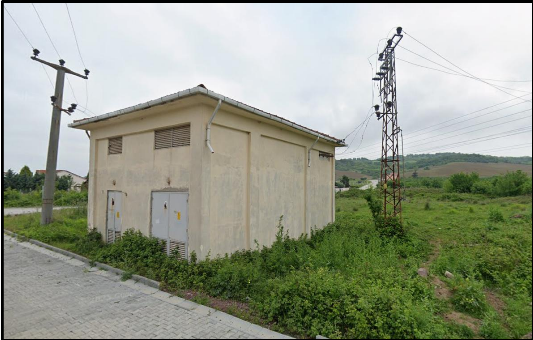
112 Ada 1 Nolu Parseldeki Trafo Alanına Ait Görsel
